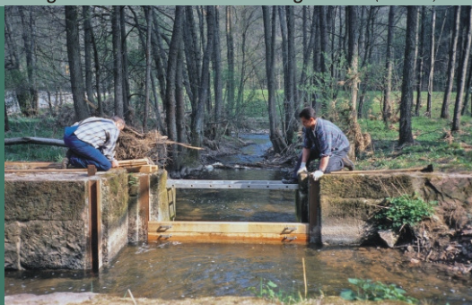
Mit Hilfe des Wehres wird die optimale Wassermenge auf die Wässerrwiesen geleitet. (M. Mack)
